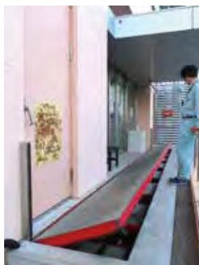
エネルギーセンター出入口の止水板
