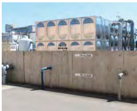
受水槽および井水プラント
